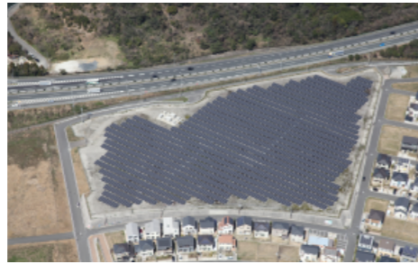
⑥ エネ・シード吉志太陽光発電所 発電規模：2.3MW
