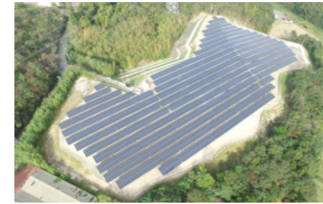
⑨ エネ・シード嘉麻太陽光発電所 発電規模：1.7MW
