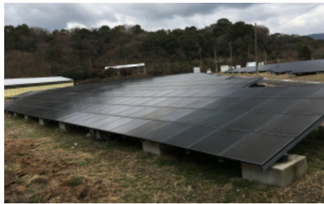
⑪ エネ・シード飯塚太陽光発電所 発電規模：1.4MW
