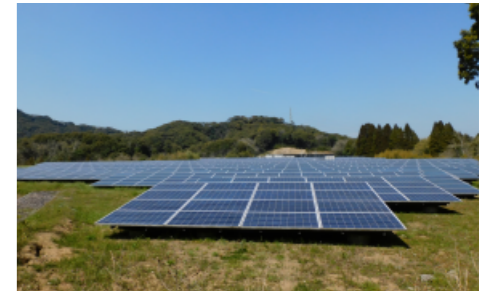
⑩ エネ・シード都城太陽光発電所 発電規模：1.6MW
