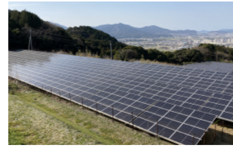
⑧ エネ・シード早良太陽光発電所 発電規模：1.0MW
