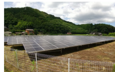
㉒ エネ・シード上天草太陽光発電所 発電規模：1.3MW
