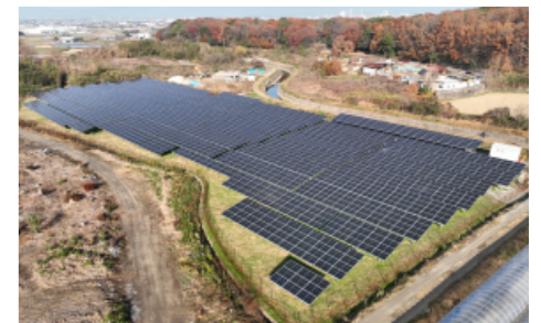
⑯ エネ・シード久留米太陽光発電所 発電規模：1.0MW
