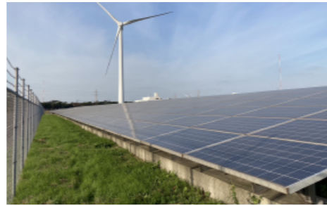
⑦ エネ・シード北九州第2太陽光発電所 発電規模：2.4MW
