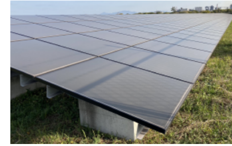
③ エネ・シード北九州太陽光発電所 発電規模：1.8MW
